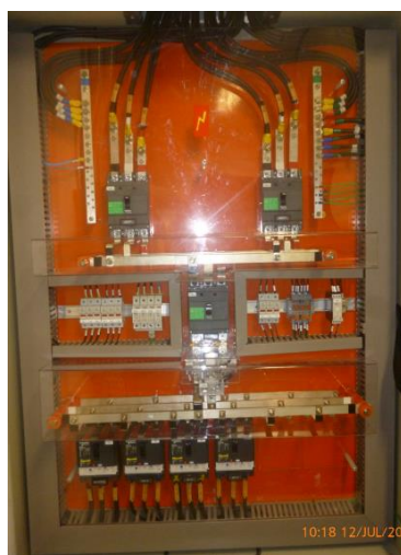
Figura 10 – QGDNB1 – Quadro de Paralelismo dos Nobreaks 1.1 e 1.2
