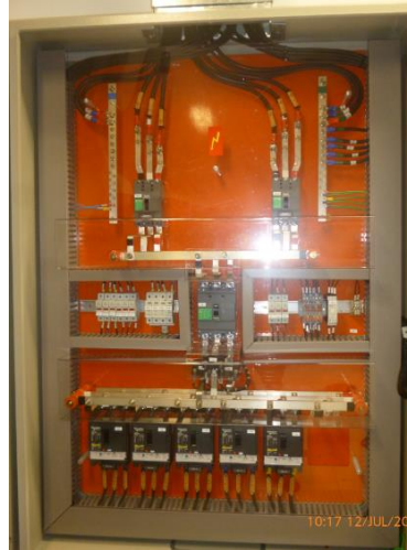
Figura 11 – QGDNB2 – Quadro de Paralelismo dos Nobreaks 2.1 e 2.2
