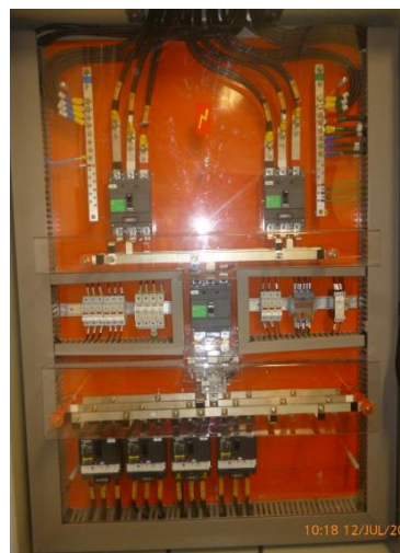
Figura 10 – QGDNB1 – Quadro de Paralelismo dos Nobreaks 1.1 e 1.2
