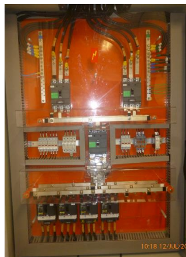
Figura 10 – QGDNB1 – Quadro de Paralelismo dos Nobreaks 1.1 e 1.2
