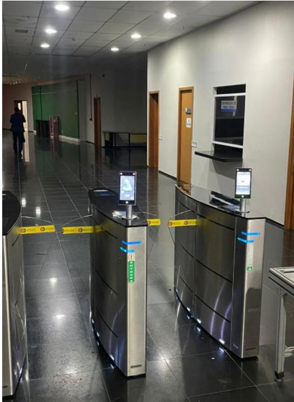
Figura 05 - Equipamentos Instalados na Sede da PGJ-MA
