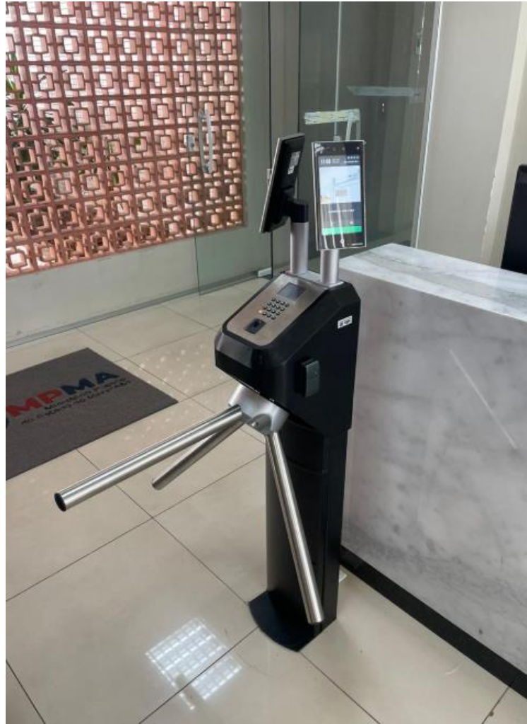
Figura 03 - Equipamentos Instalados na Promotoria de São José de Ribamar
