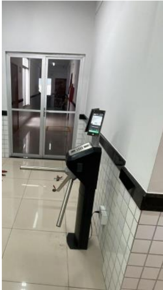
Figura 02 - Equipamentos Instalados na Promotoria de Paço do Lumiar
