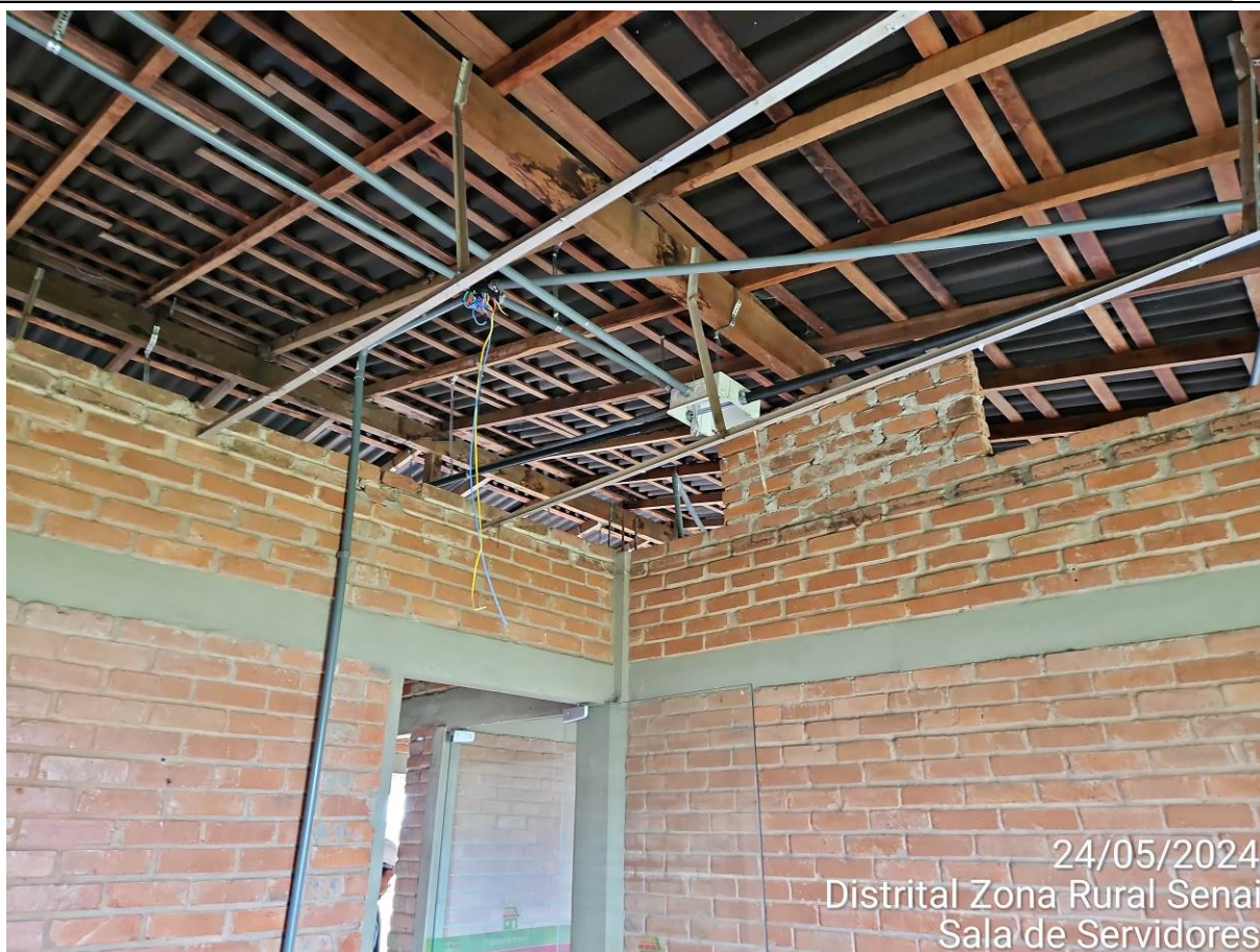
Foto 31 - Sala de Servidores
