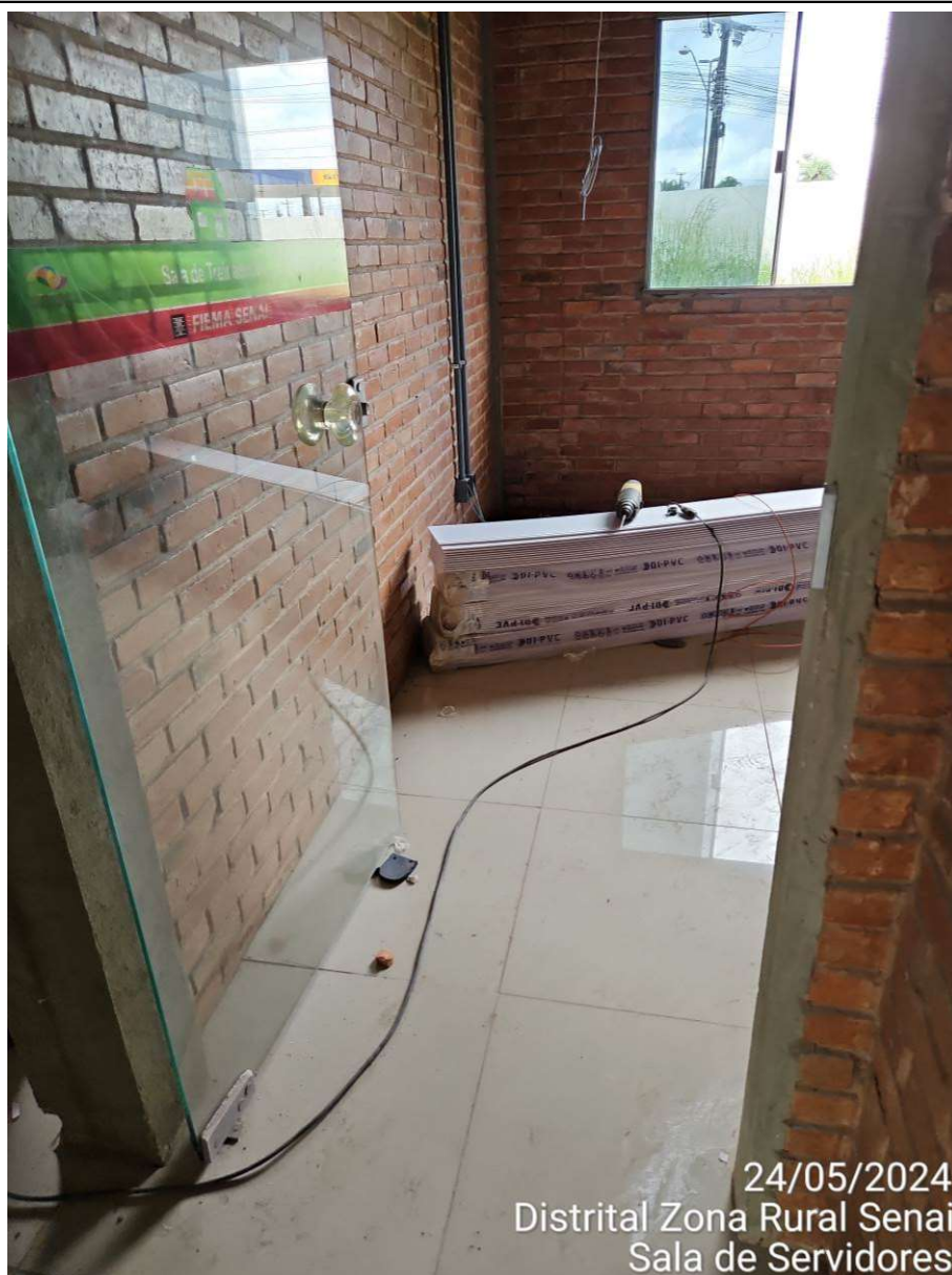
Foto 28 – Sala de Servidores
