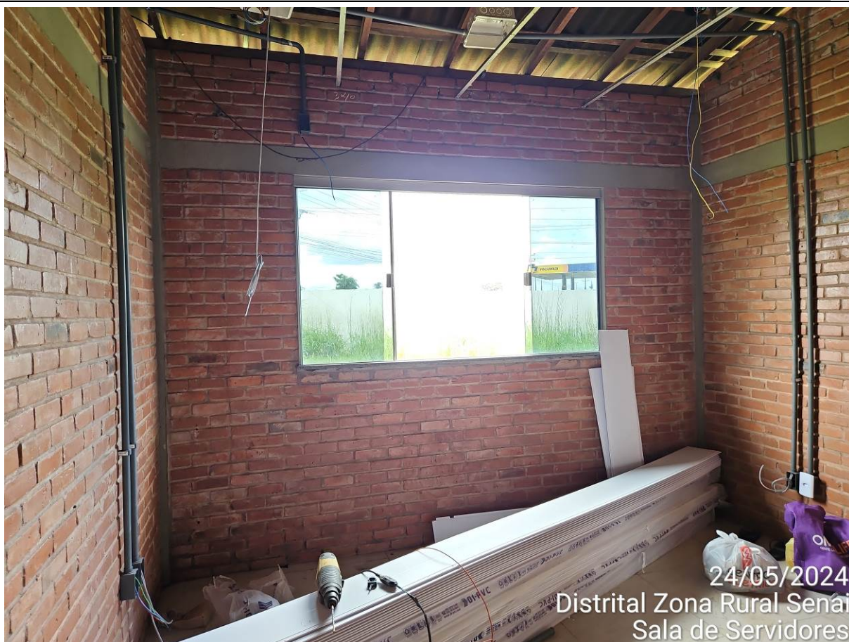
Foto 29 - Sala de Servidores
