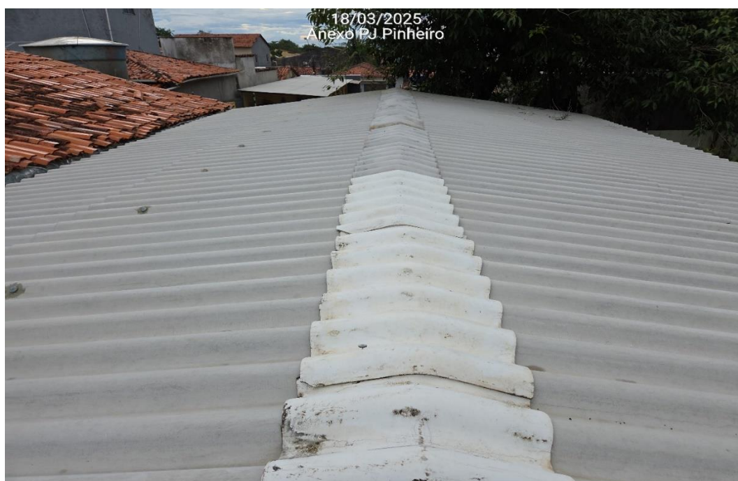
Figura 16 - Telhado com algumas não conformidades: telhas mal fixadas com parafusos que não estão nas ondas das telhas, as borrachas dos parafusos não estão em contato com as telhas, a cumeeira está solta
