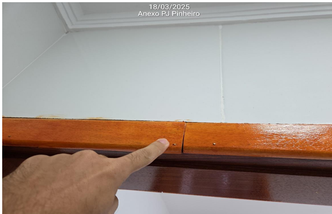
Figura 3 Alisar não conforme, com emenda, além disso as portas não foram corretamente envernizadas, não houve lixamento correto entre demãos, a textura das portas está rugosa
