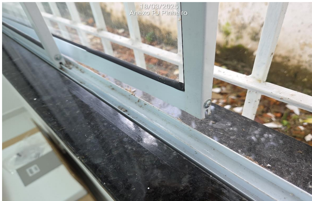
Figura 5 Janelas fora dos trilhos, não abrem corretamente
