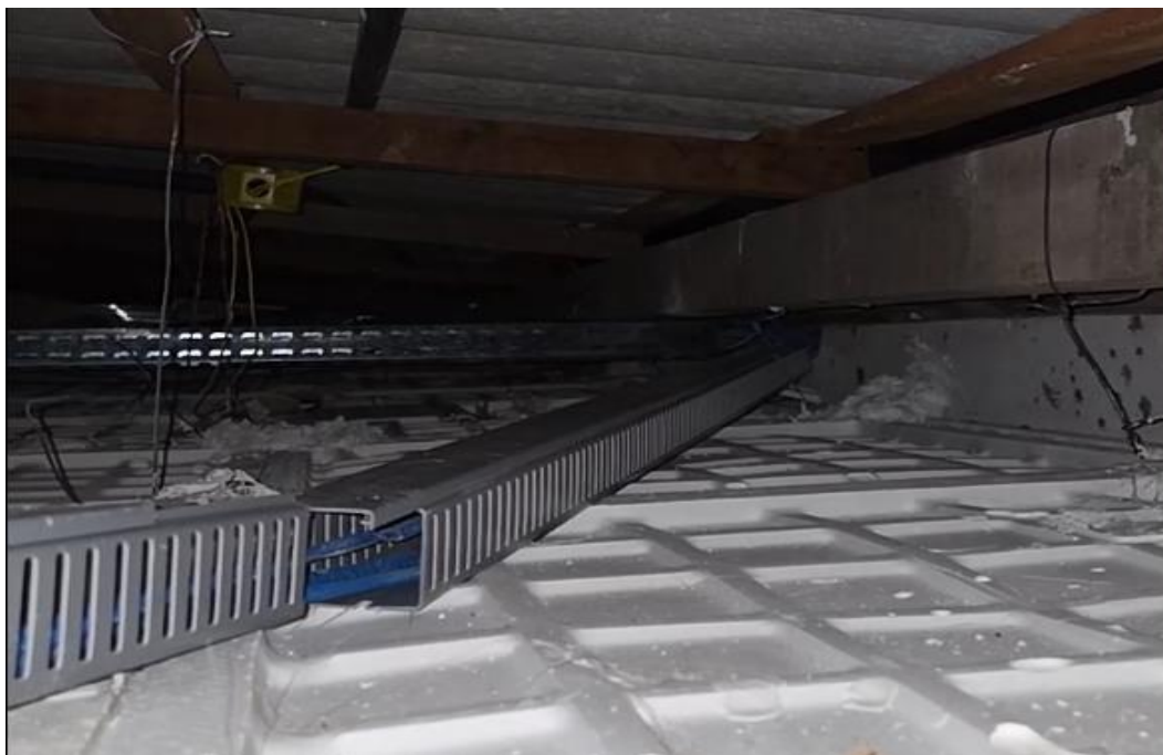
Figura 1 Ainda constam trechos de canaleta plástica no forro, sendo que pelo projeto, as canaletas devem metálicas
