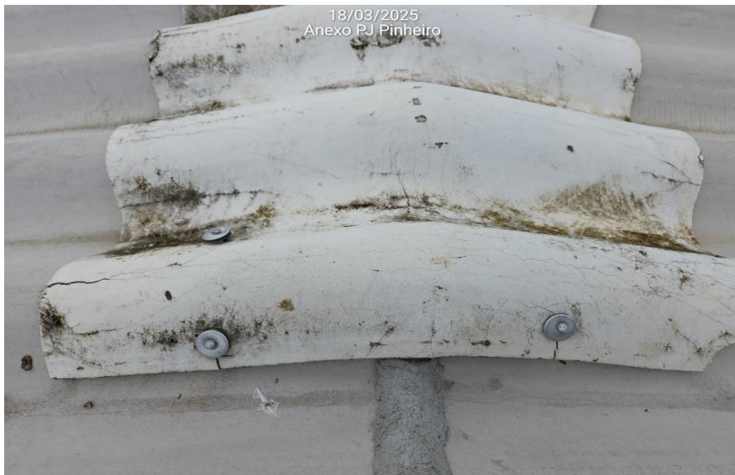
Figura 17 - Há um trecho onde cumeeira que não é nova, está quebradiça, mal fixada. Há um trecho que não foi usado cumeeira e sim massa
