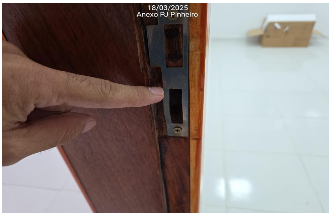
Figura 13 - Algumas portas estão batendo ao fechar, pois a cava (rebaixo) da chapa da porta não foi feita, ficando a mesma elevada
