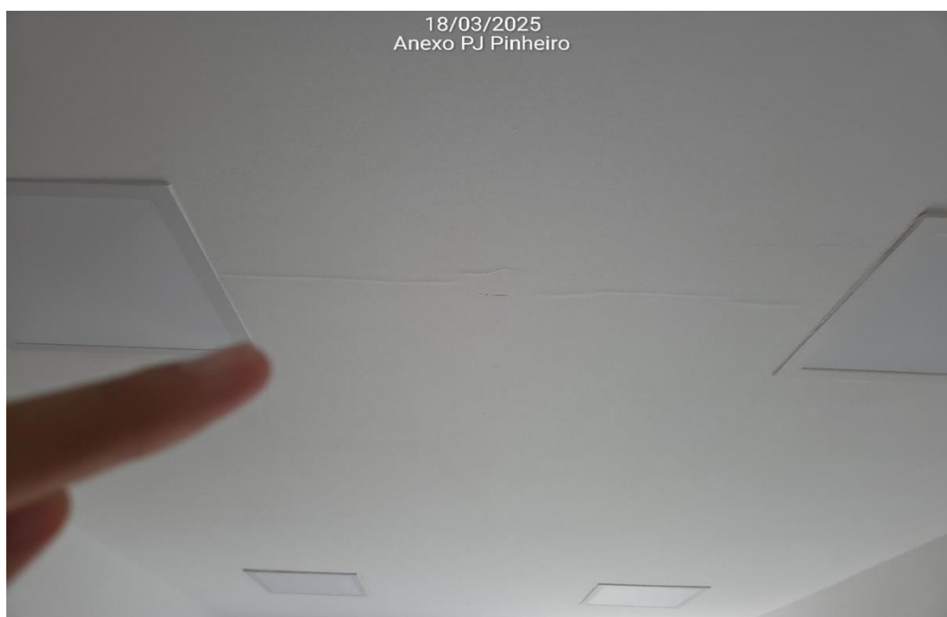
Figura 14 - Marcas no forro, possível surgimento de trinca se persistir
