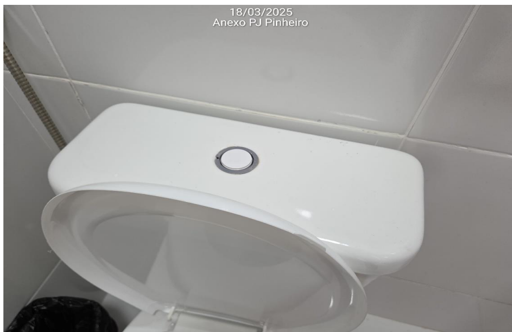
Figura 4 Botão de descarga avariado
