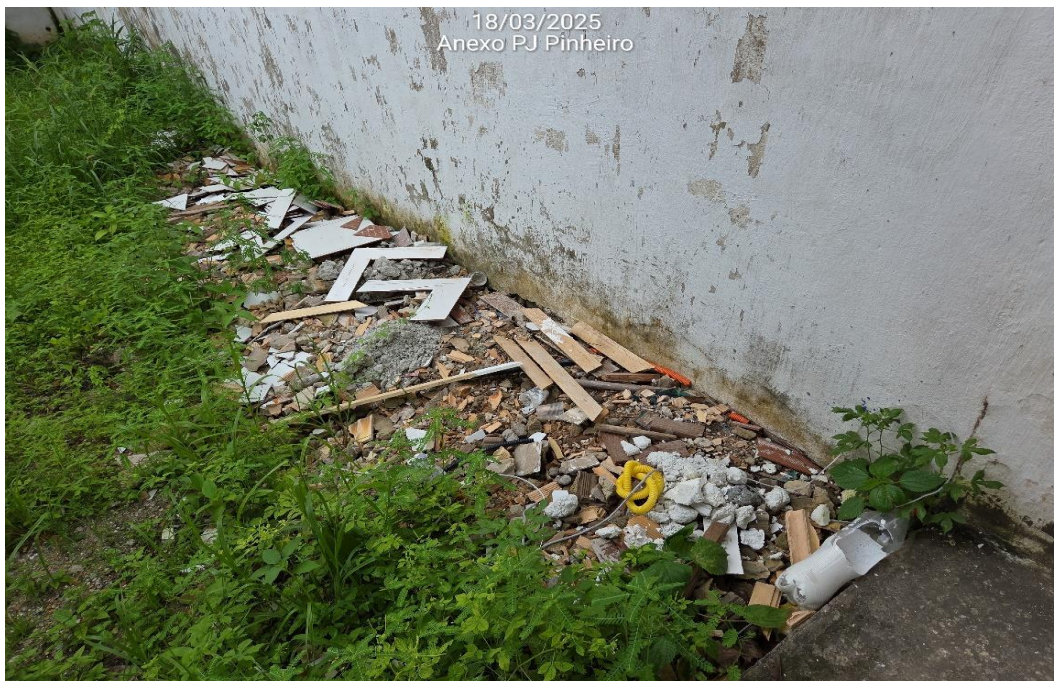
Figura 11 - Restos de entulho da obra que não foram recolhidos para bota-fora
