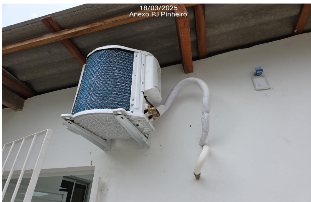
Figura 10 - Unidades condensadoras não estão fixadas nas bases corretamente, falta fixação com parafusos
