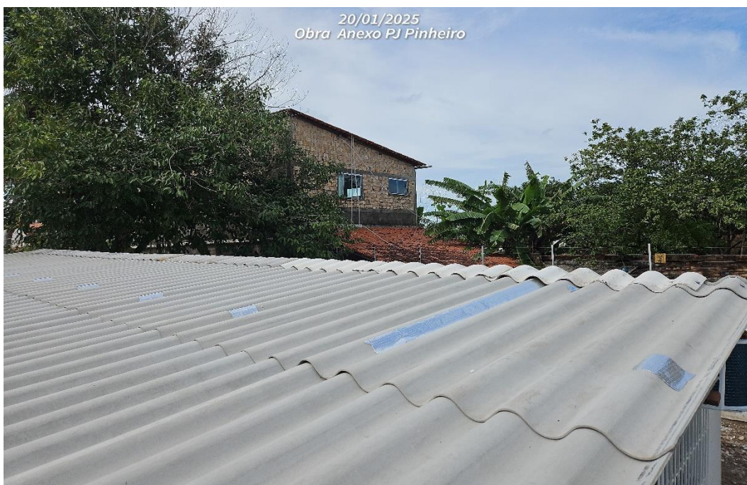
FOTO 7 - Não consta fixação das telhas via parafusos, algumas telhas possuem furos, além disso há diversas emendas com manta, deve-se efetuar a troca das telhas avariadas por novas, sem furos ou avarias.
