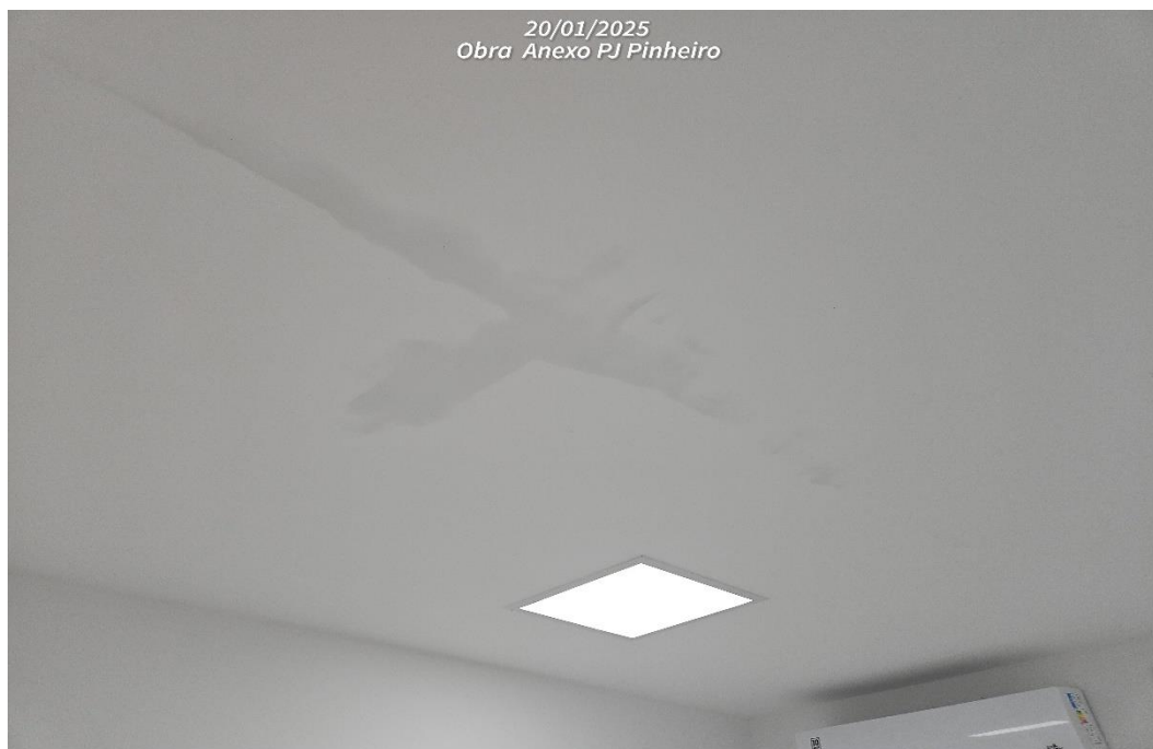
FOTO 1 - Manchas na pintura/possível infiltração no forro
