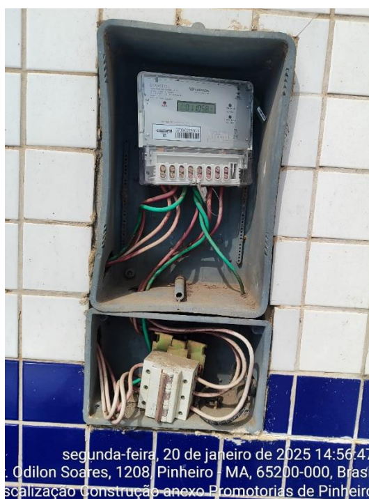
FOTO 18 – Não foi substituído o ramal de serviço nem Disjuntor de entrada no QM
