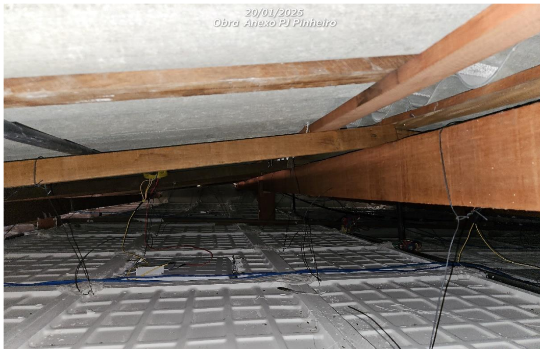
FOTO 10 - Reforçar a fixação do forro de gesso, uma vez que consta apenas pequenos trechos de arames simples, insuficientes para o peso da estrutura de gesso
