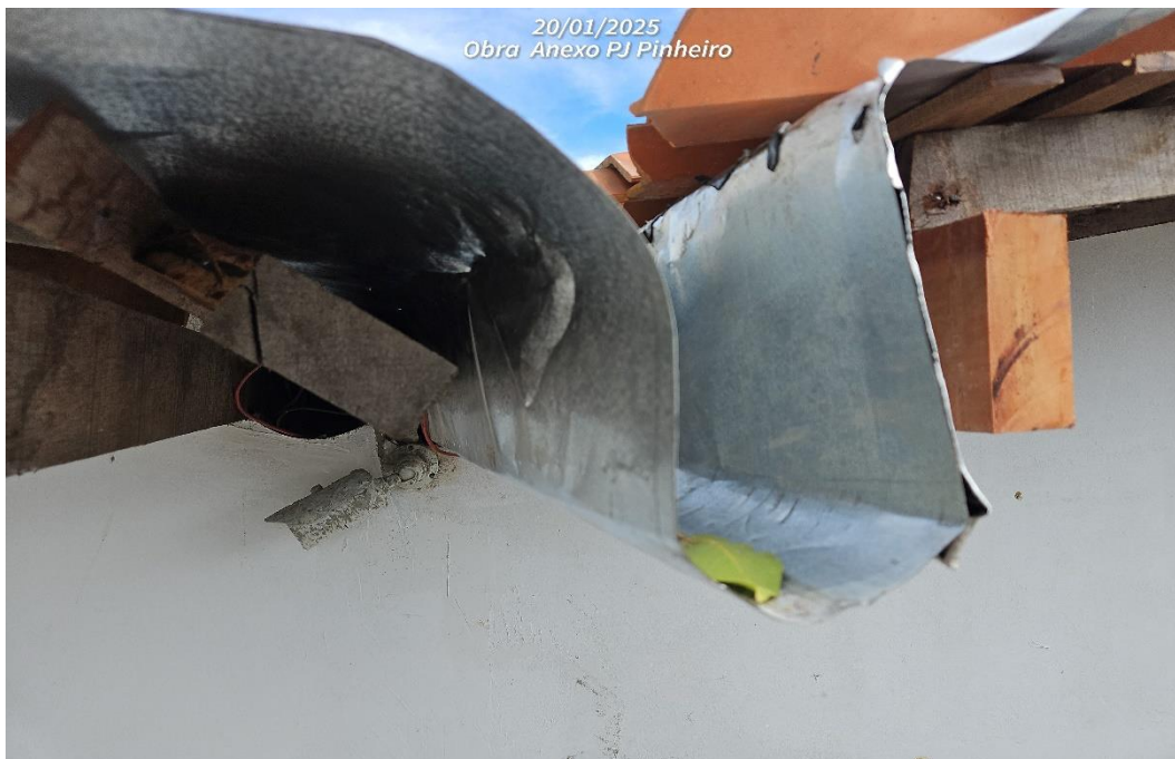
FOTO 8 - A calha está com dimensões inferiores ao especificado, com uma largura bem inferior aos 0,3m necessários para drenar corretamente a contribuição das duas águas dos telhados. Além disso a planilha prevê uma descida pluvial com tubulação de 100mm (itens 19)
