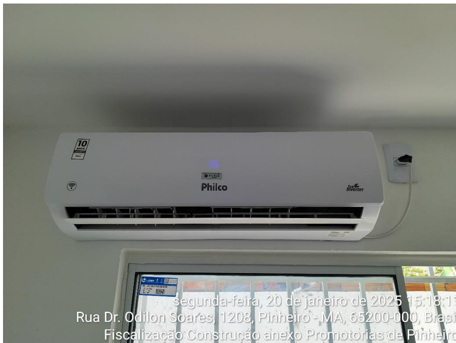
FOTO 143 – Emenda inadequada nos plugues de força de condicionadores de ar
