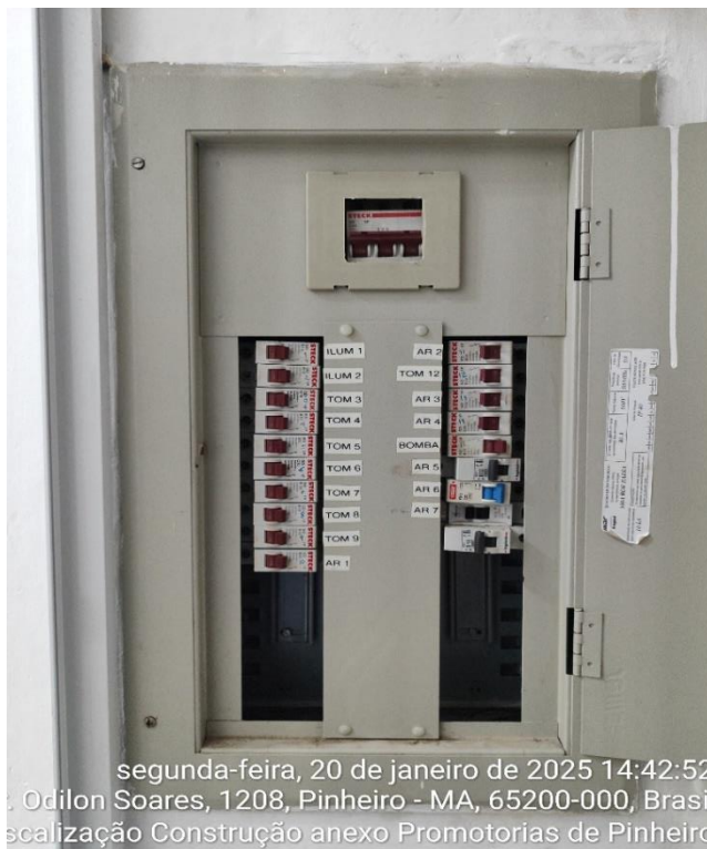
FOTO 17 – QD1 não obedece ao projeto elétrico: sem disjuntor tripolar de saída para QD2, nem DPS's, interligação ao barramento principal com cabos, faltam circuitos, padrão de cores incorreto
