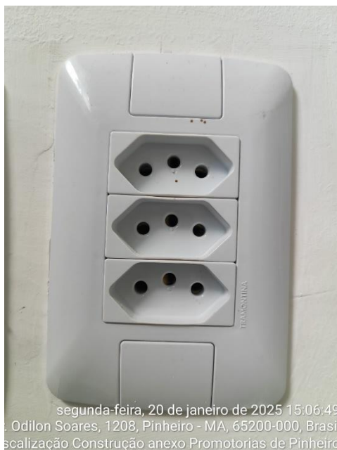
FOTO 154 – Tomada instalada de 10 A e não de 20 A conforme especificação
