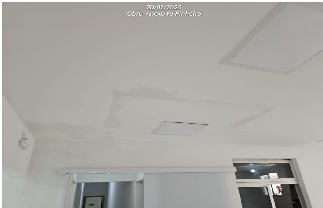
FOTO 6 - Manchas na pintura/possível infiltração no forro
