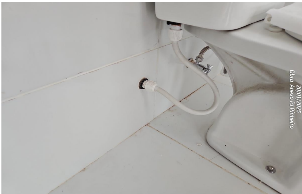
FOTO 2 - Os engates flexíveis dos vasos sanitários são em metal, conforme item 20.1 da planilha
