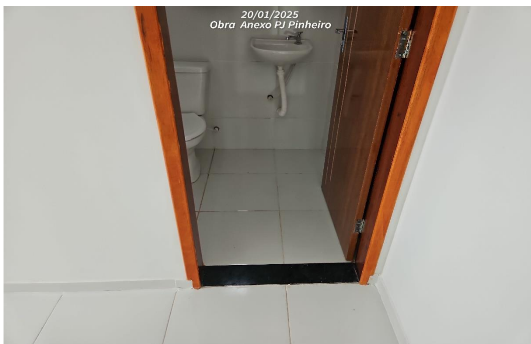
FOTO 5 - Alisar das portas mal pintados, não foram lixados, superfície rugosa, verniz destoando da tonalidade da porta
