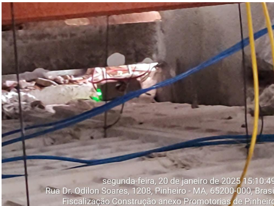
FOTO 165 – Cabos UTP não tubulados, lançados diretamente sobre o forro e sem aplicação de eletrocalhas
