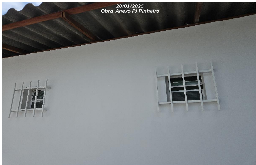
FOTO 11 – Os basculantes estão com dimensões inferiores as previstas em projeto e falta peitoril (0,5x0,6m). Deve-se executar nas dimensões corretas, bem como executar o peitoril.
