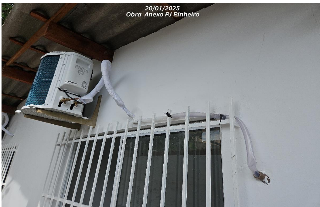
FOTO 9 - A disposição do dreno está ruim, com a mangueira estrangulada, deve-se providenciar tubulação em PVC entre o dreno do Split e a descida vertical
