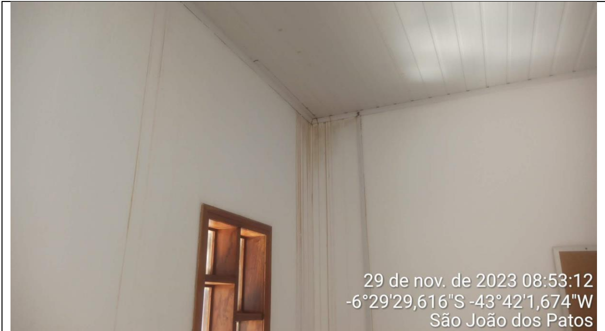
Mancha em pintura na recepção
