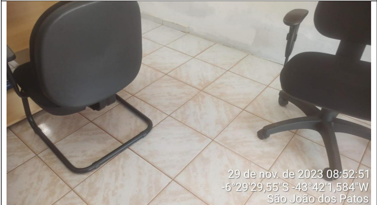
Piso desgastado sala de atendimento
