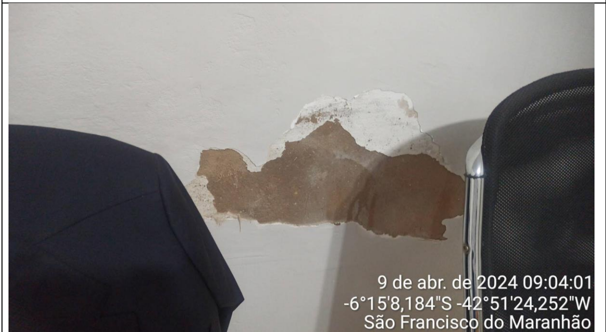
Gabinete (pintura deteriorada)
