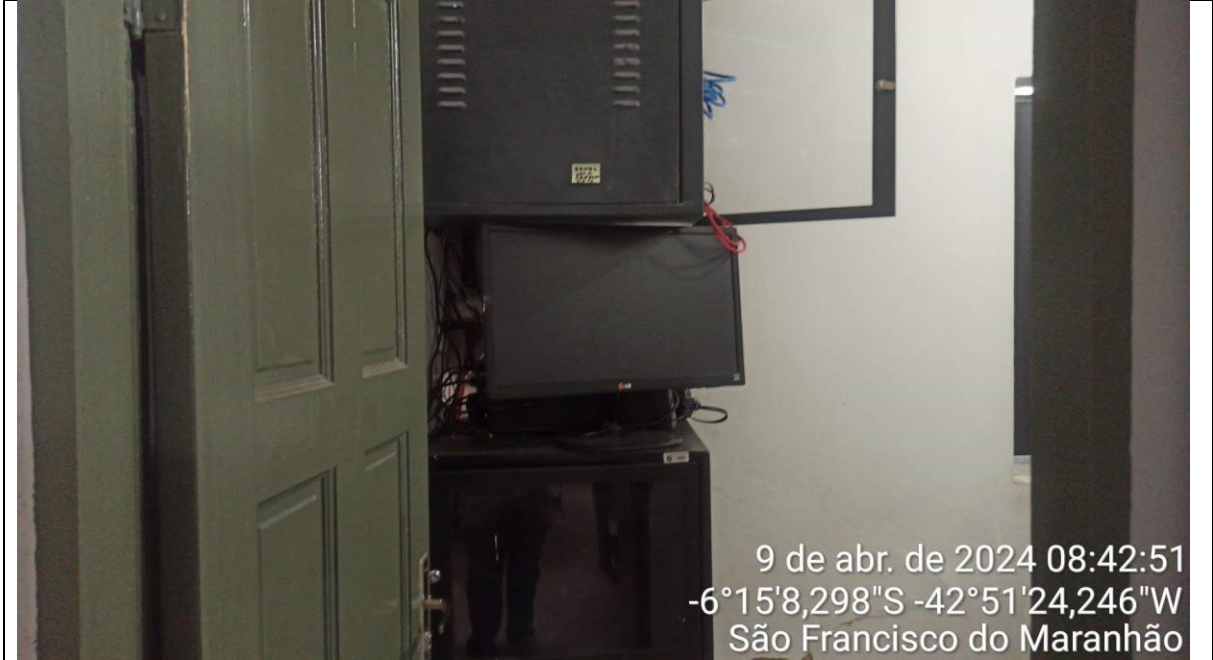
Sala de rack
