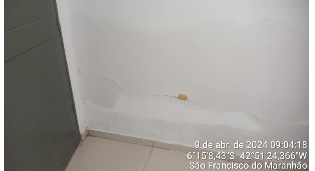
Gabinete (reboco deteriorado pela umidade)
