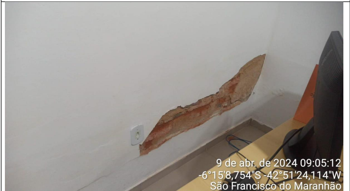
Gabinete do Promotor (reboco deslocado)
