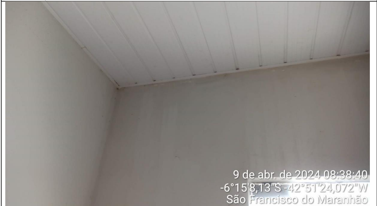
Infiltração a partir da cobertura
