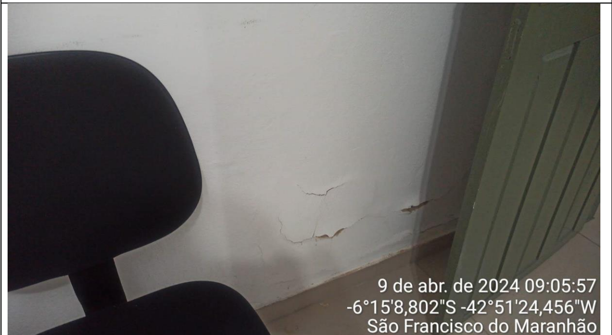
Gabinete do Promotor Pintura deteriorada pela umidade
