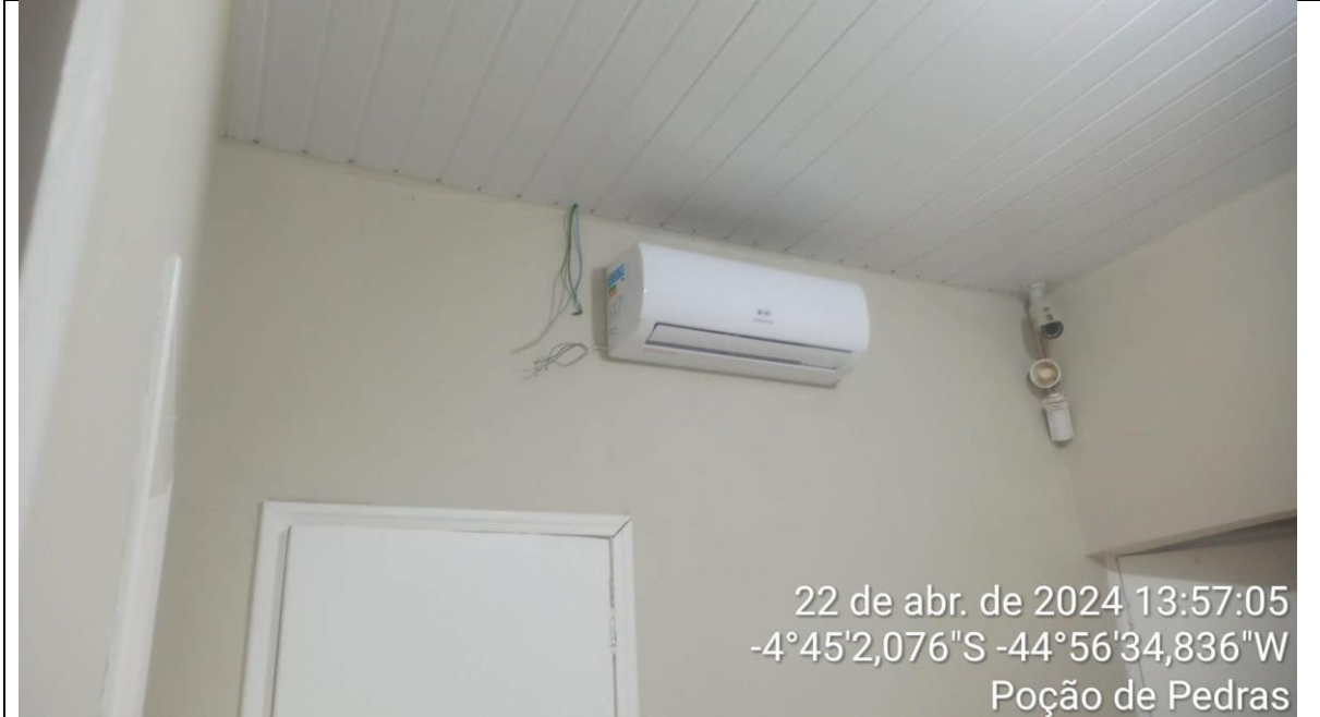
Ar condicionado aparentemente desconectado da rede elétrica (fiação exposta)
