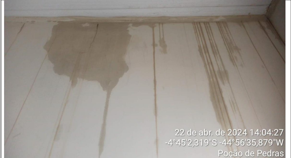
Banheiro privativo infiltração a partir da cobertura
