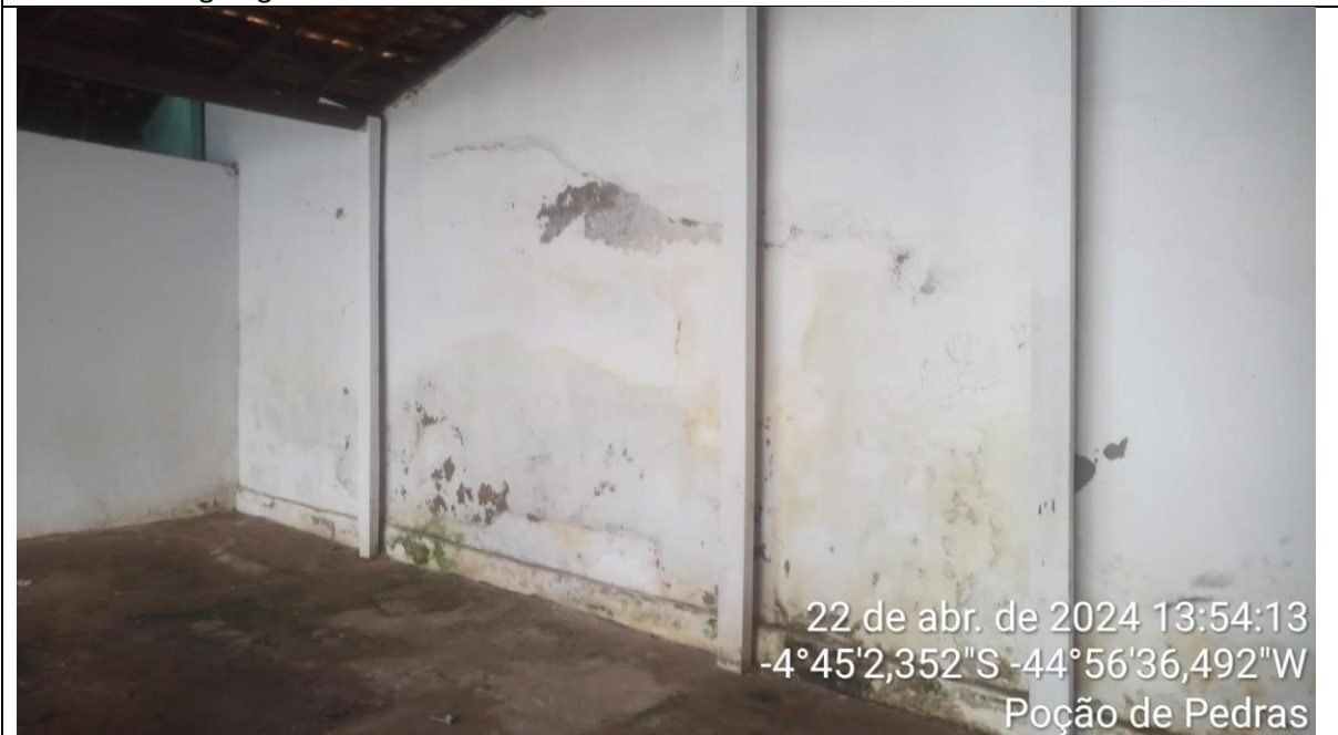
Parede com manchas por infiltração (Garagem)
