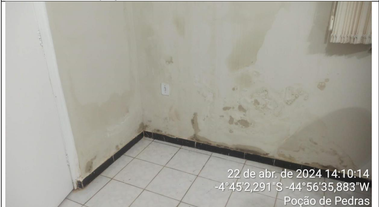
Sala da assessoria infiltração generalizada
