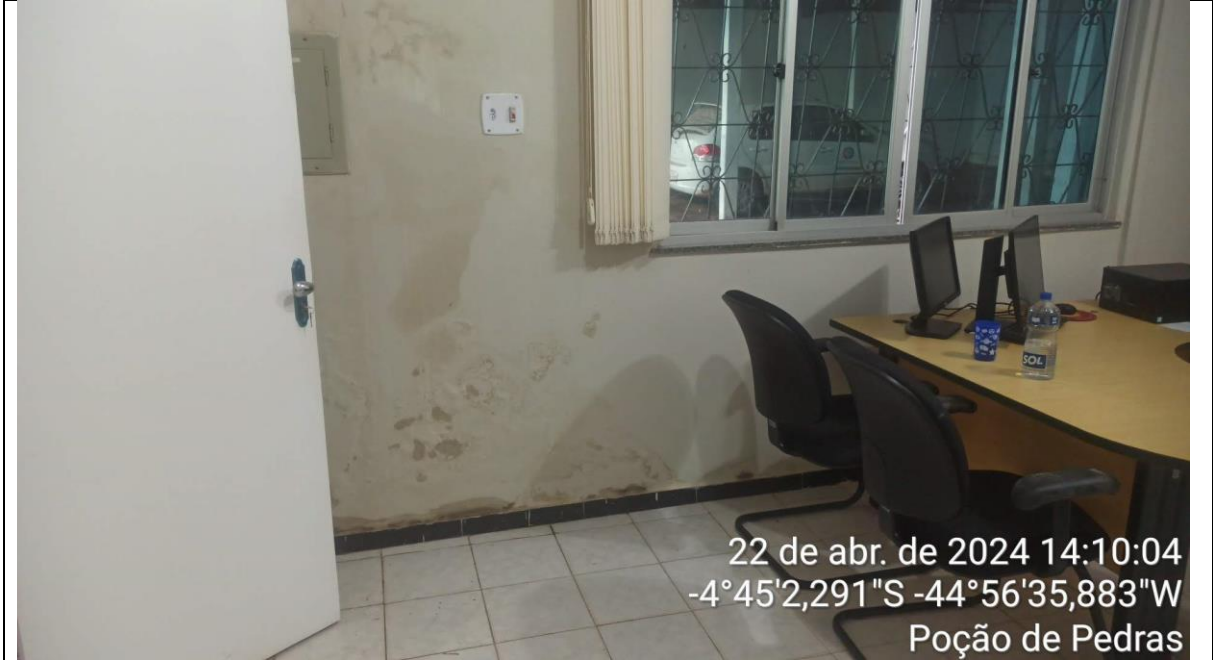
Sala da assessoria infiltração generalizada
