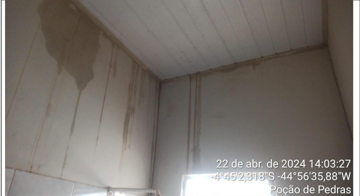
Banheiro privativo infiltração a partir da cobertura
