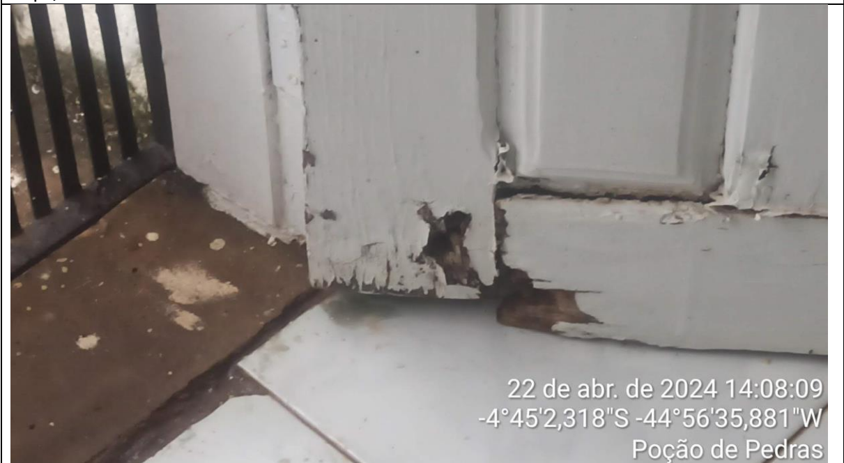
Copa/cozinha Porta deteriorada
