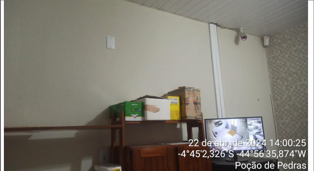
Arquivo e sala de monitoramento
