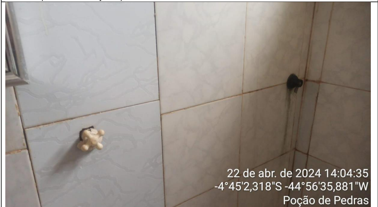
Banheiro privativo torneiras completamente deterioradas
