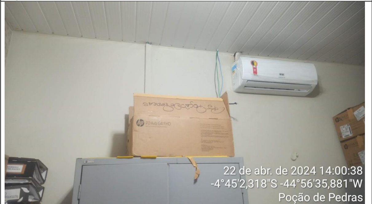
Arquivo e sala de monitoramento (ar condicionado aparentemente desconectado da rede elétrica)
