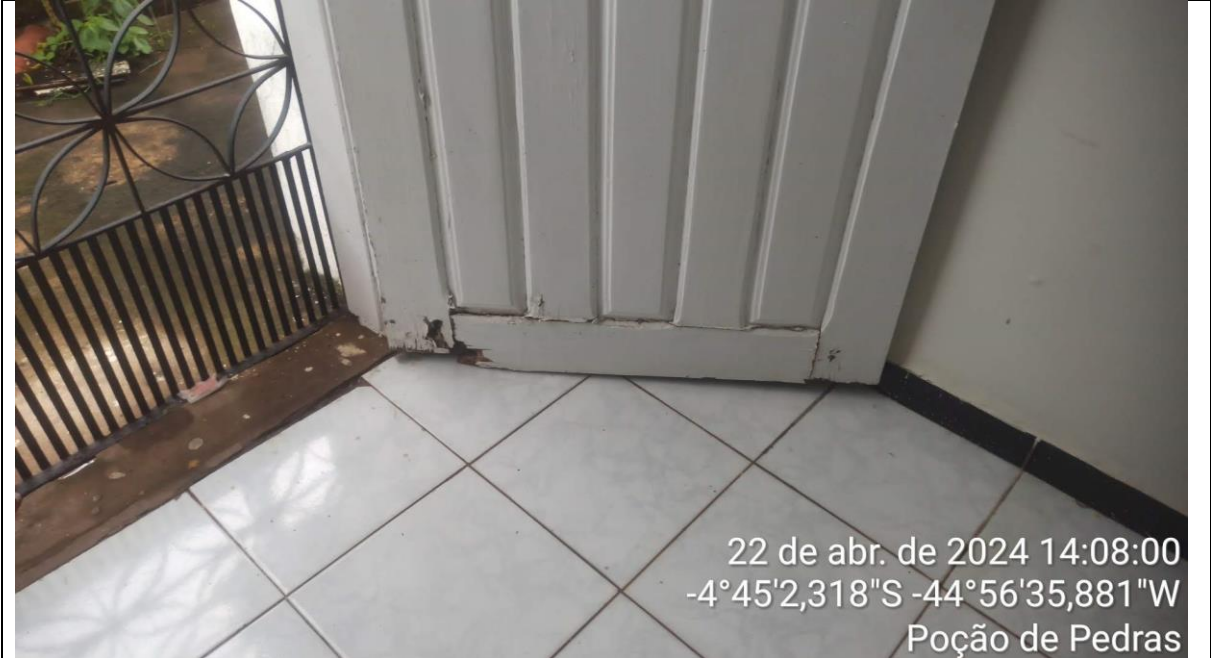
Copa/cozinha Porta deteriorada
