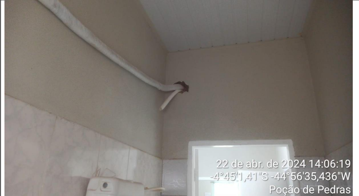
Banheiro público (dreno de ar condicionado com solução de continuidade)
