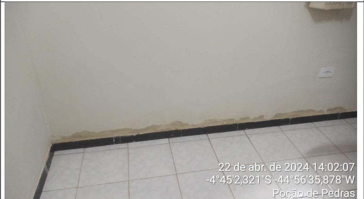
Sala de servidores infiltração por umidade ascendente
