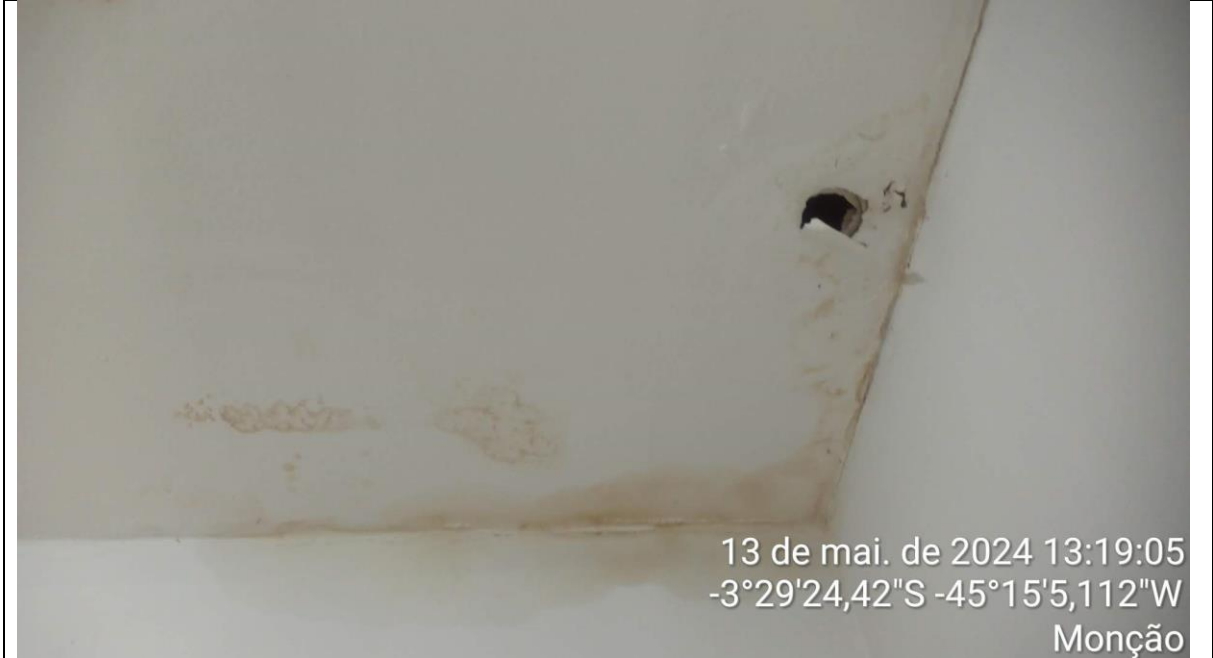
Gabinete do Promotor (forro deteriorado por infiltrações advindas do teto)
