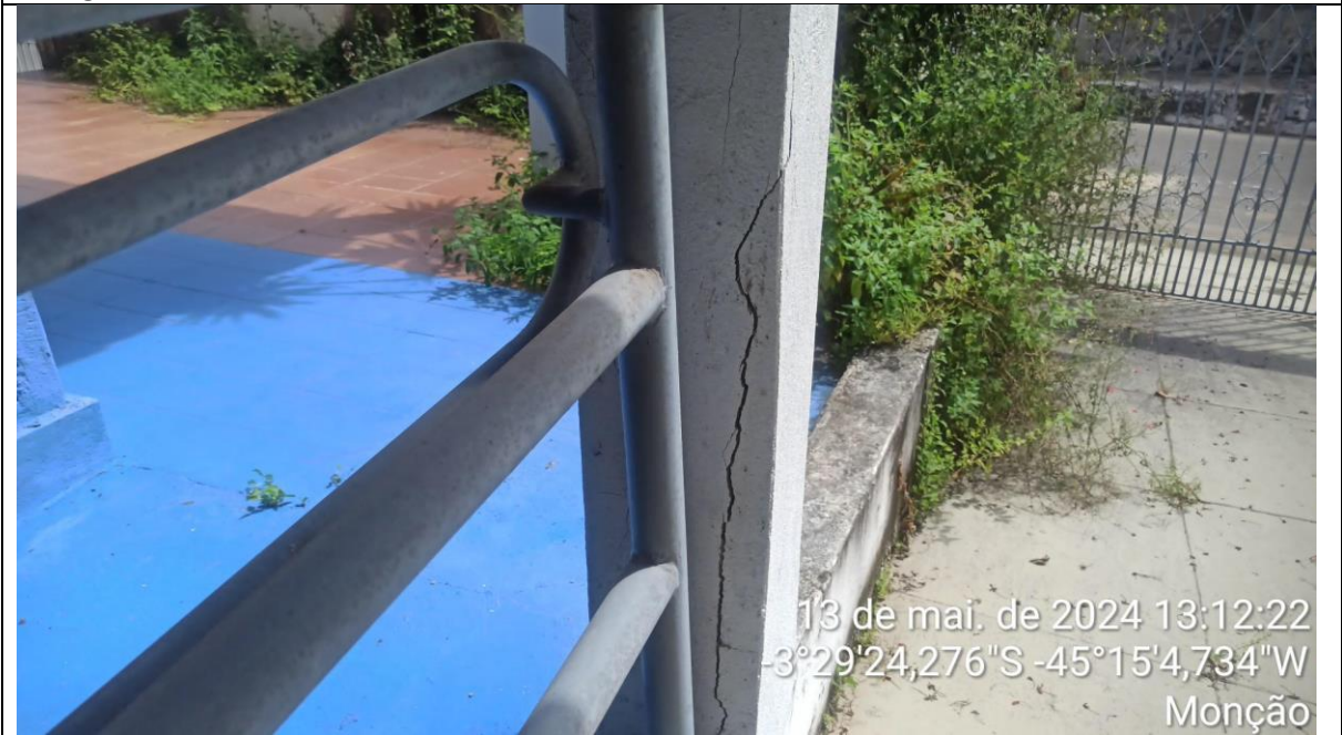
Fissura em pilar na garagem
