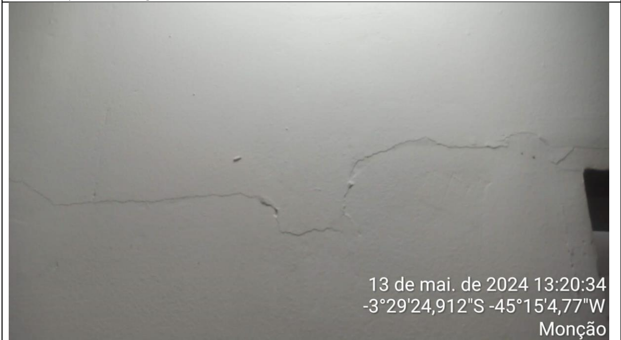
Banheiro privativo do gabinete do Promotor (trinca em parede)
