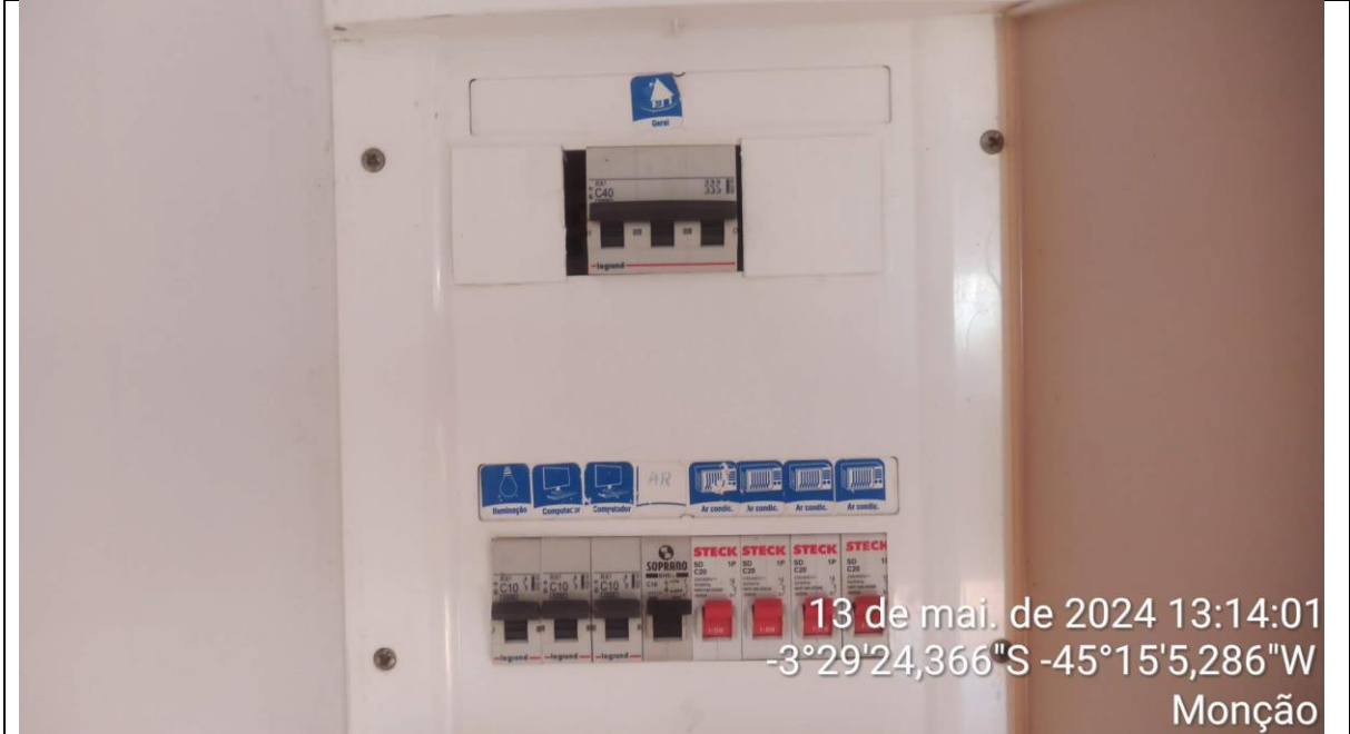
Quadro de distribuição
