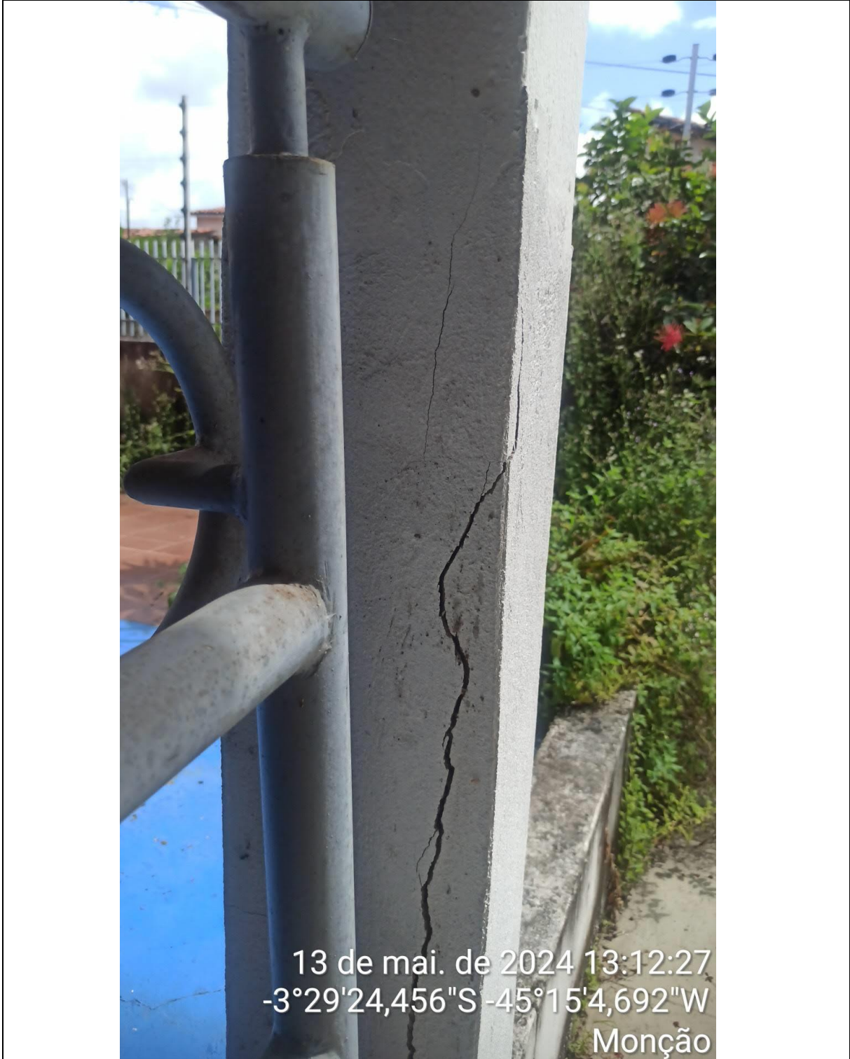
Fissura em pilar da garagem
