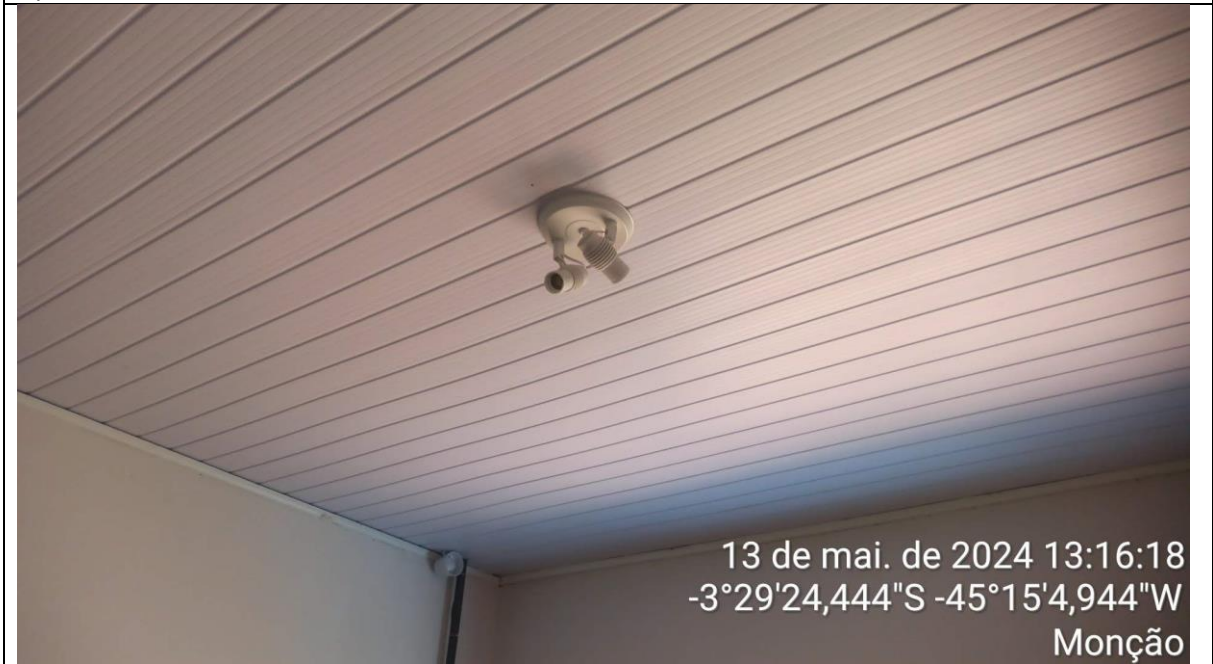
Apoio Administrativo (falta de lampadas)
