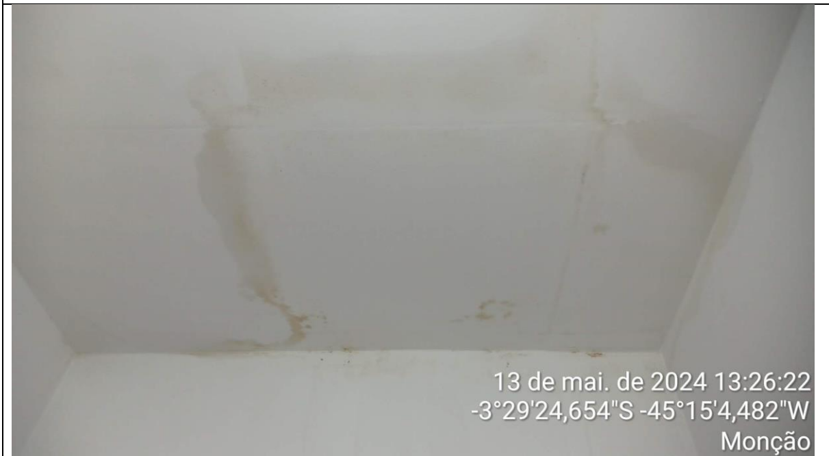
Banheiro Público (mancha de infiltração advinda da cobertura)
