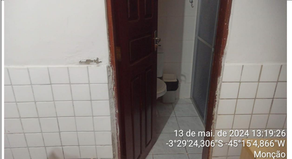
Gabinete do Promotor (pintura descascando)
