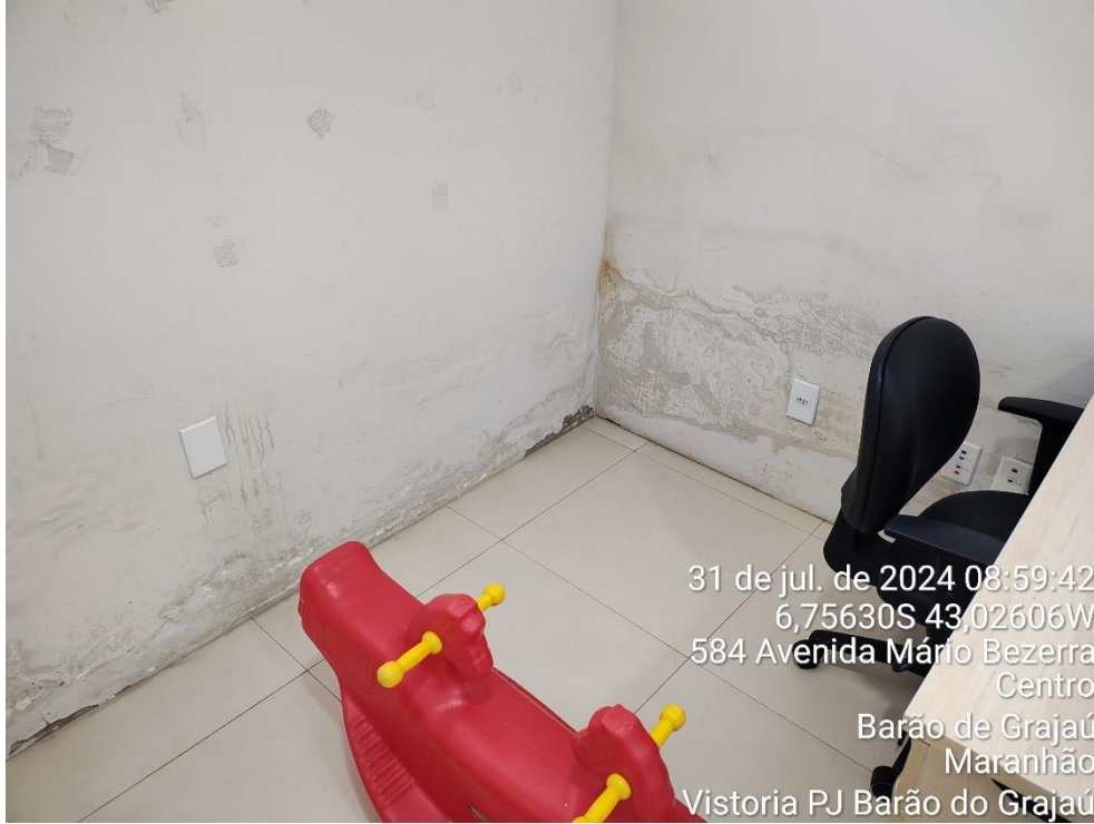
Foto 5 - Paredes com afofamentos e degradação ocasionado por infiltração ascendente;
