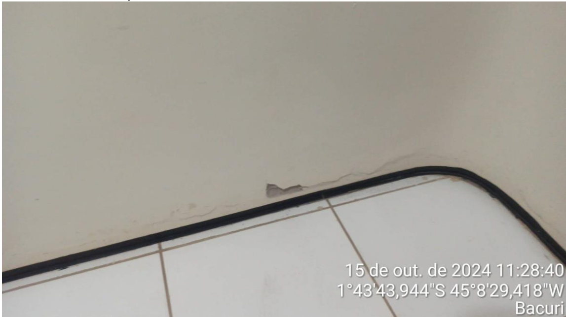
Sala de atendimento trinca em parede
