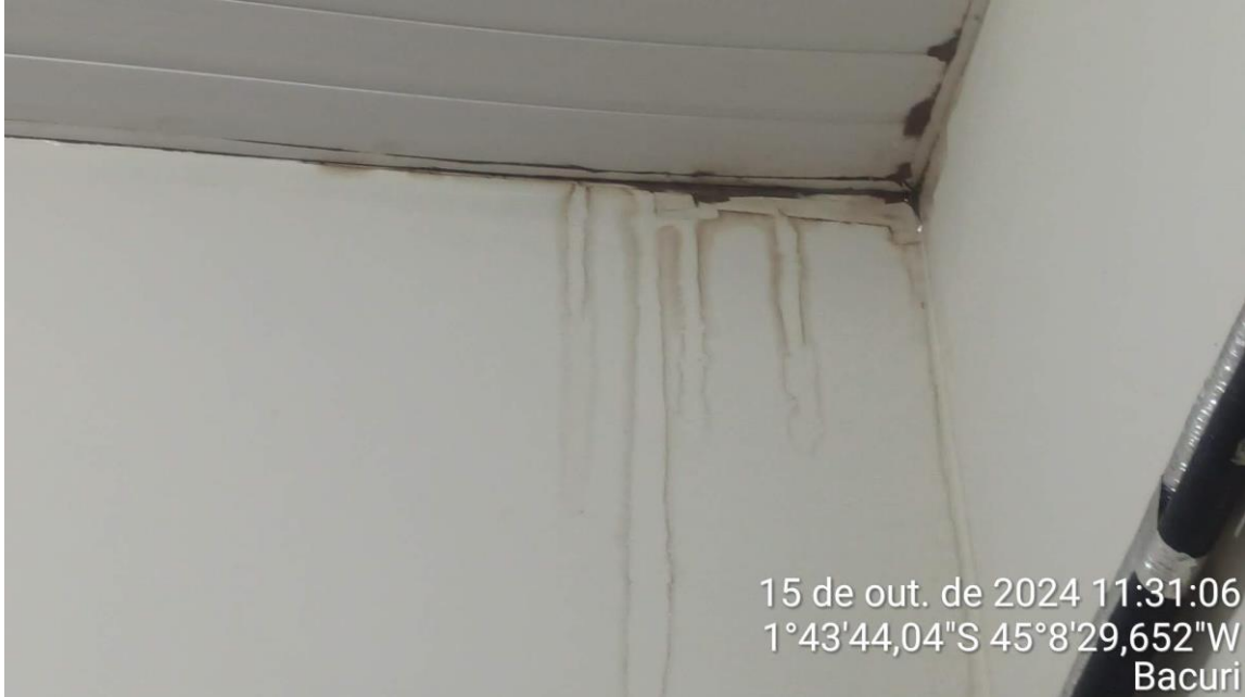
Secretaria infiltração advinda do teto (goteira)
