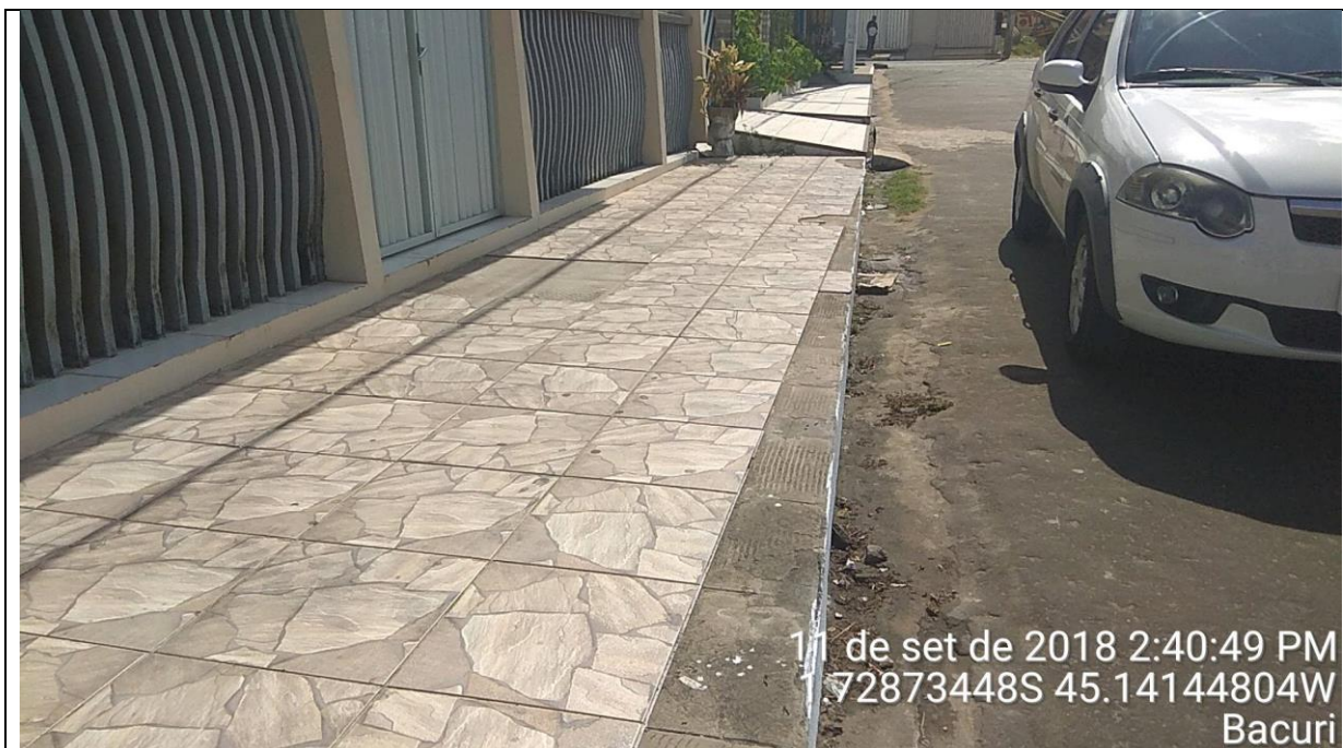
Calçada com lajotas faltando
