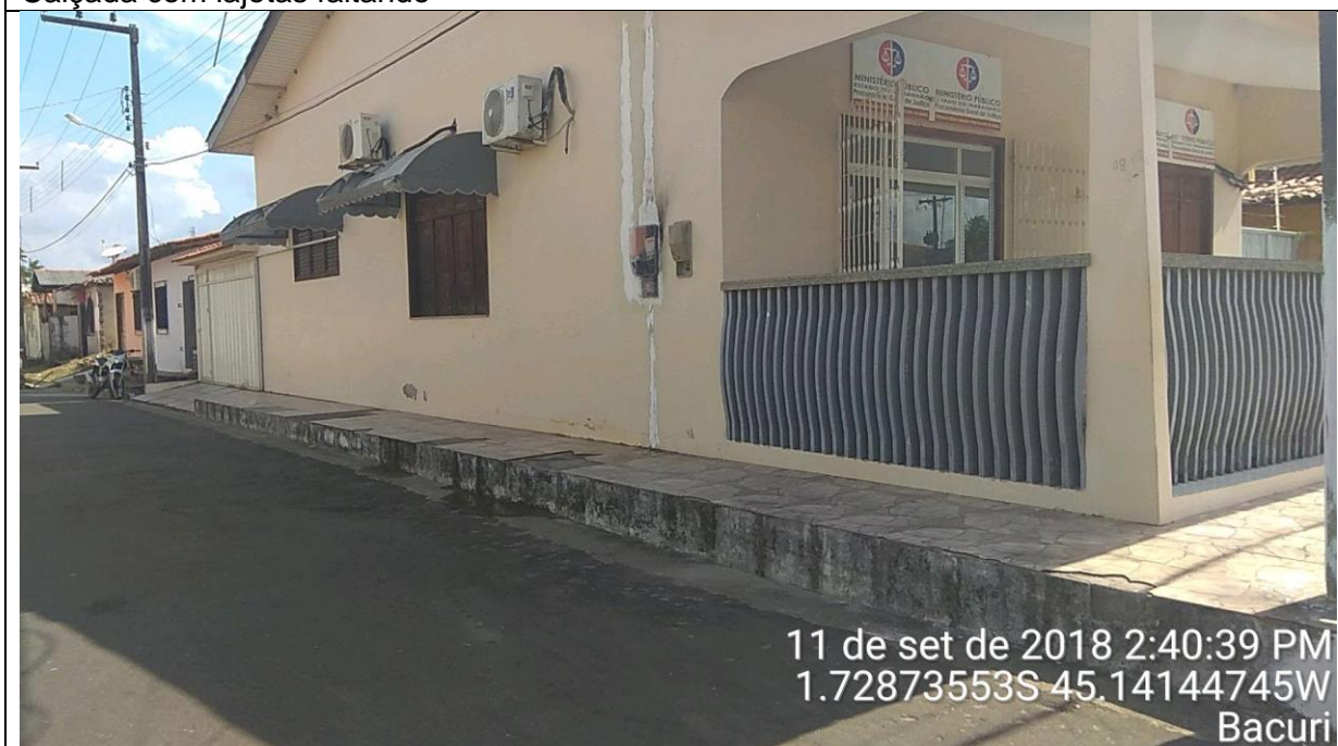
Fachada lateral – serviço executado sem recomposição da pintura
