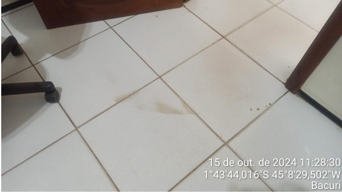
Sala de atendimento piso deteriorado
