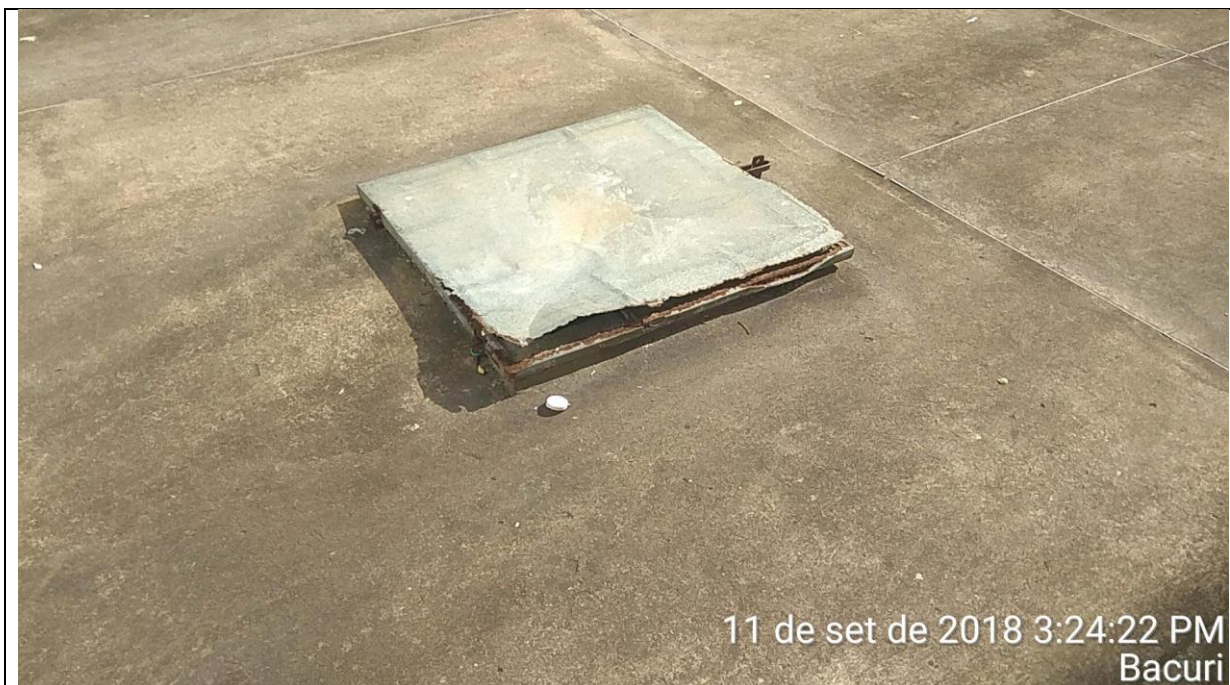
Tampa da cisterna deteriorada
