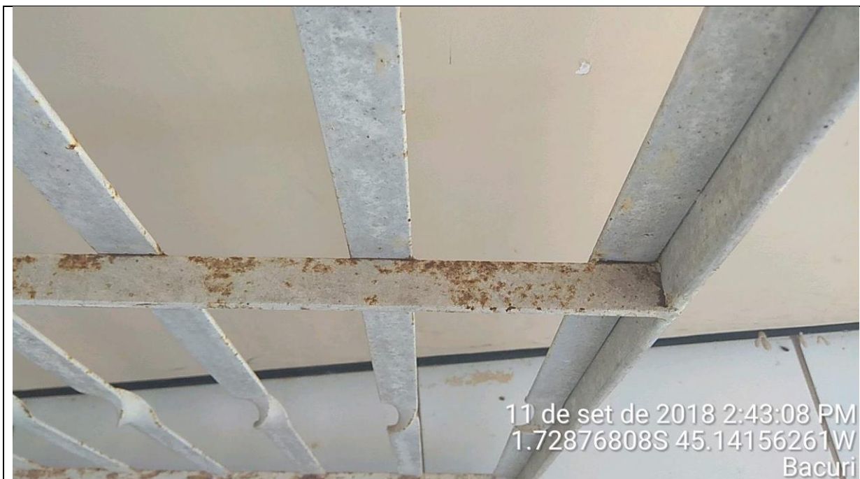
Oxidação em gradil da porta principal
