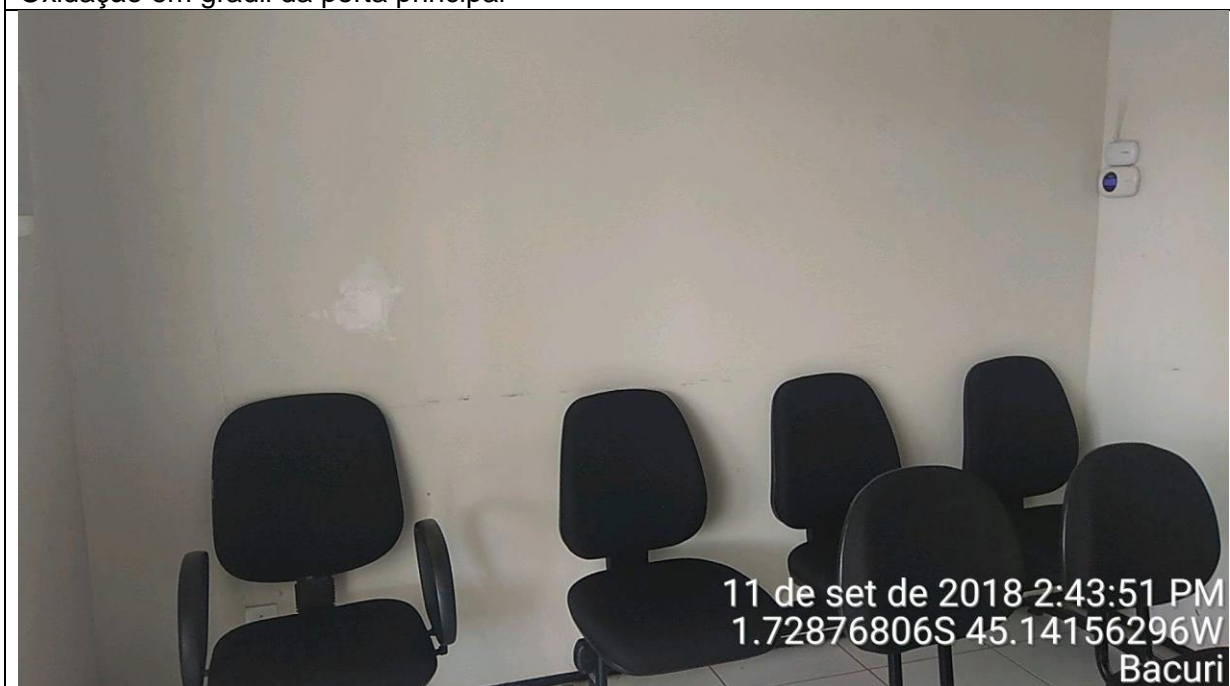
Recepção pintura deteriorada
