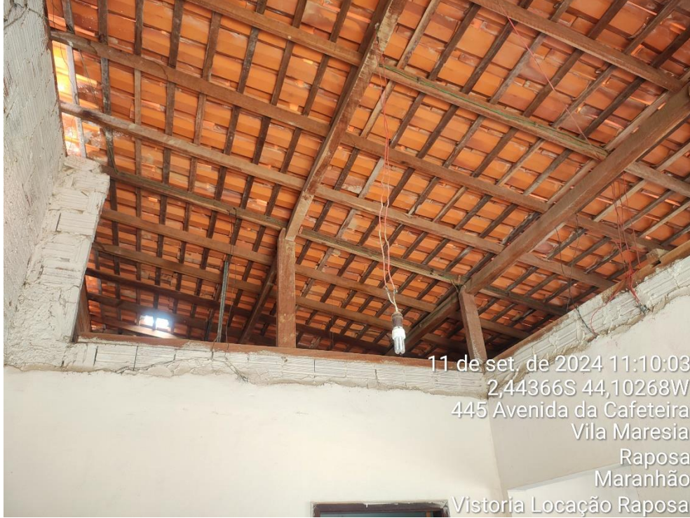
Foto 13 – Casa principal não é forrada;
