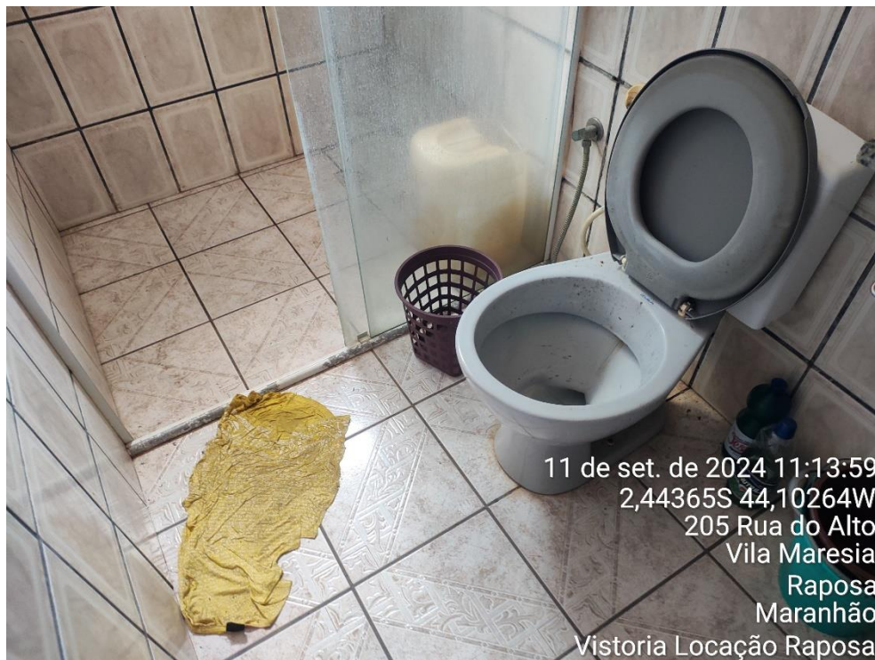
Foto 18 – Banheiro interno possui sinais claros de desgaste e metais enferrujados;
