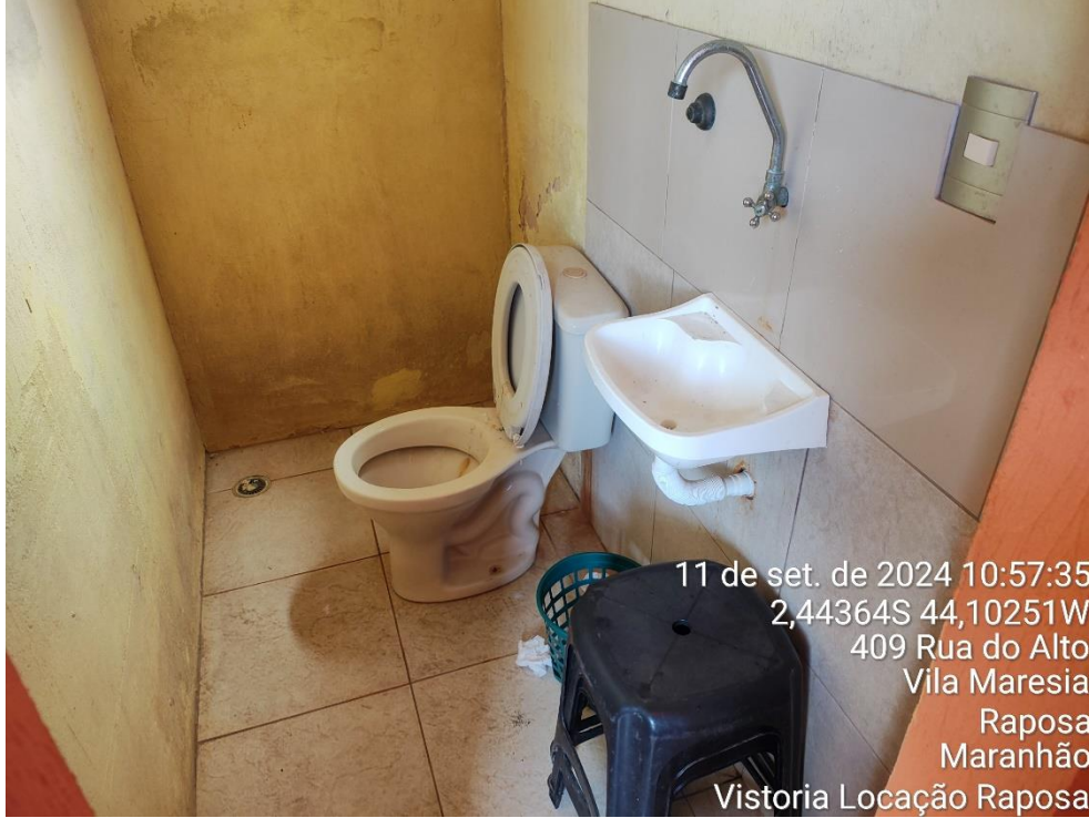
Foto 9 – Banheiro da edícula com estado de conservação ruim;
