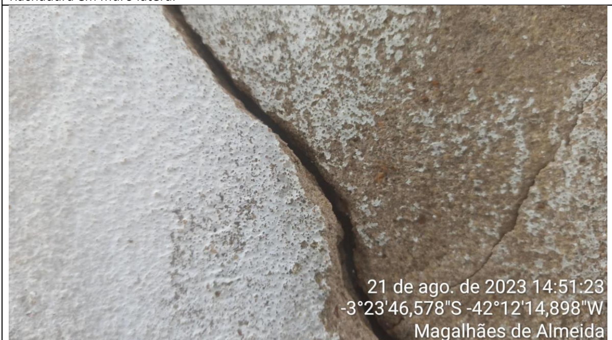
Rachadura em muro lateral
