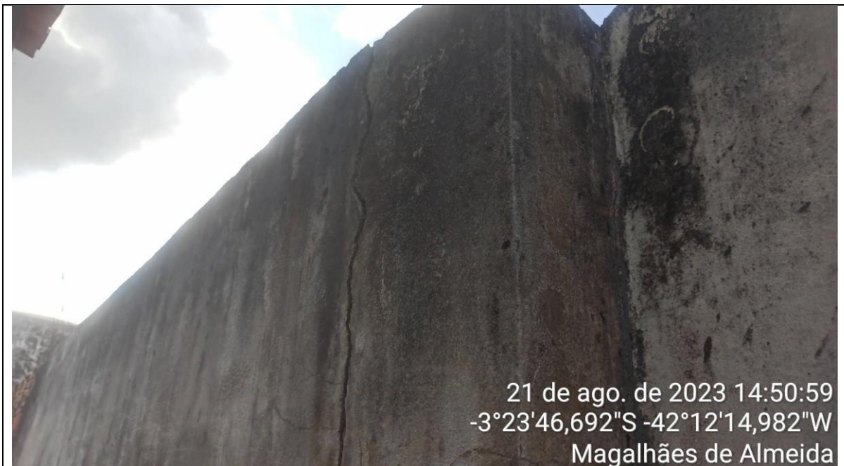
Rachadura em muro lateral
